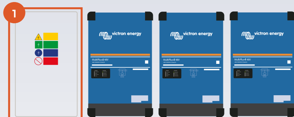
1 AC rozvaděčem FVE (AC-RZ) 3 měniče Victron Energy Multiplus-II 48 V
